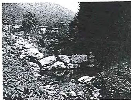
descrizione: Briglia in massi con problemi di stabilità.
